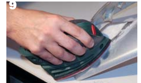
Mit feinem Schleifpapier wird die Reparaturstelle geglättet und ist bereit für den Lackiervorgang.
